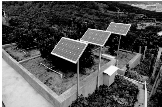
图 2 安装传感器和太阳能供电系统的小区
